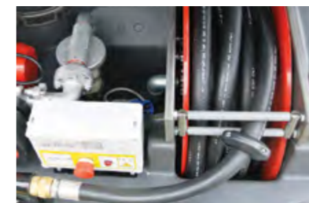
Электрический щит и катушка с пружинным приводом. Electric switchboard and spring rewind hose reel.
